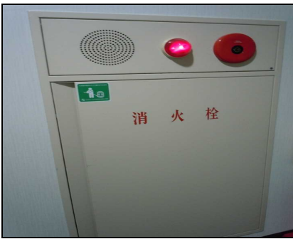
Shou ka sen 消火栓
